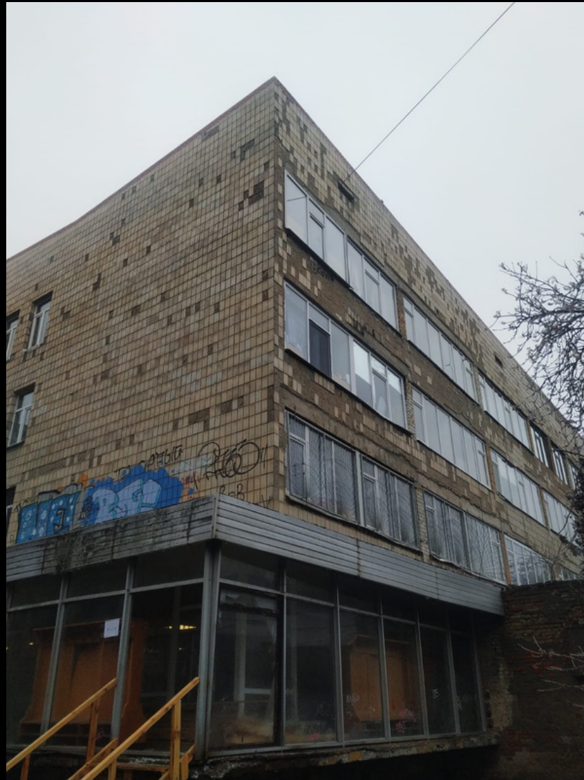
Фасад гуртожитку до початку капітального ремонту
